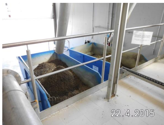
Slika 64: Odpadki, odstranjeni na mehanski stopnji čiščenja – ozračeni lovilce maščob in peskolov. Vir: Lasten
