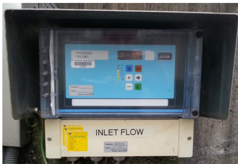
Slika 58: Zaslon merilnika pretoka (venturimeter) Vir: Lasten
