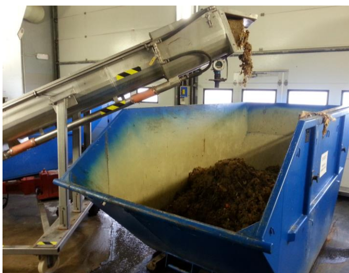
Slika 62: Stiskalnica trdnih odpadkov, odstranjenih iz odpadne vode s pomočjo finih grabelj
