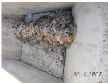
Slika 60: Odpadki, odstranjeni na mehanski stopnji čiščenja – grobe grablje. Vir: Lasten
