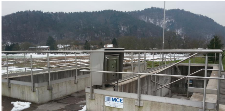
Slika 57: Merilno mesto za trajno merjenje pretoka odpadne vode z venturimetrom Vir: Lasten
